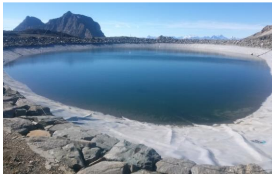
Figure 1 – Géomembrane PVC assurant l'étanchéité d'une retenue d'altitude pour la production de neige de culture ; géomembrane présentant des réparations du fait d'endommagements par poinçonnement
